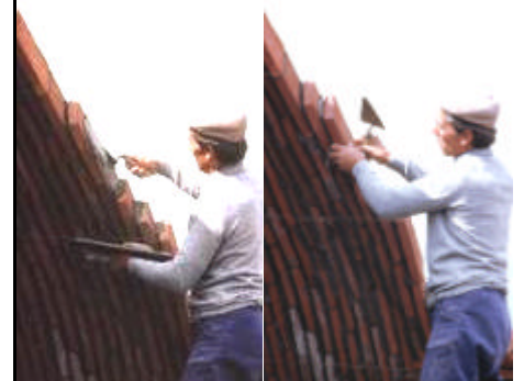
Principe constructif : type de pose La réalisation de la voûte par le maître maçon
